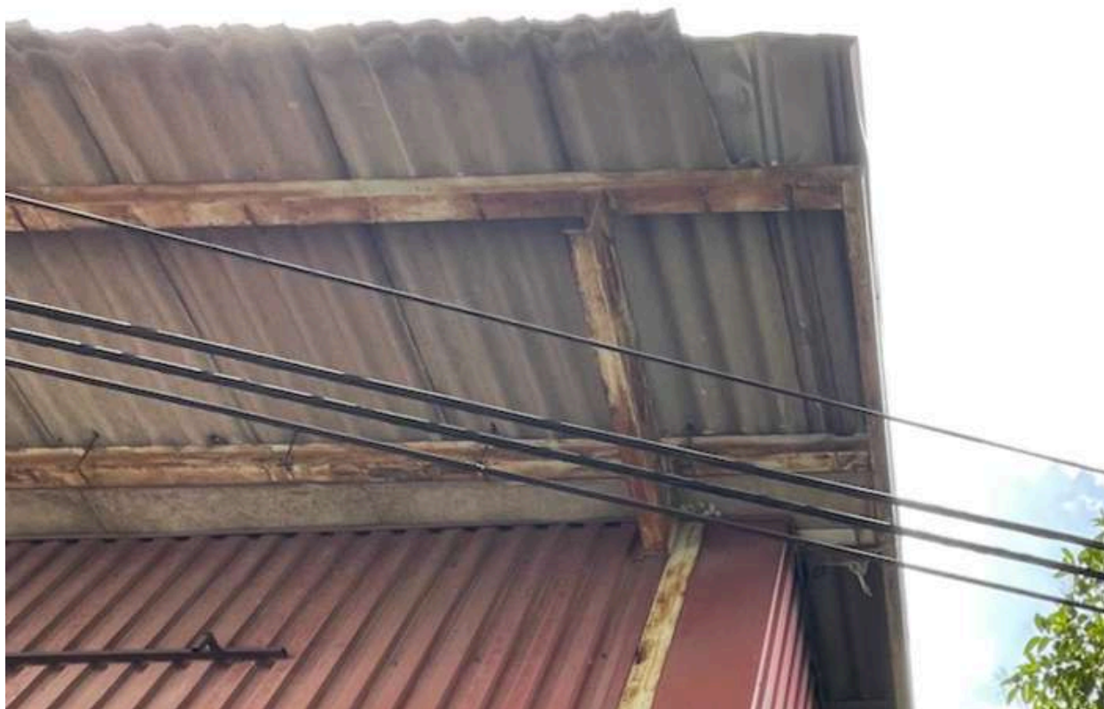
Figura 1. Borde de alero lado sur.
