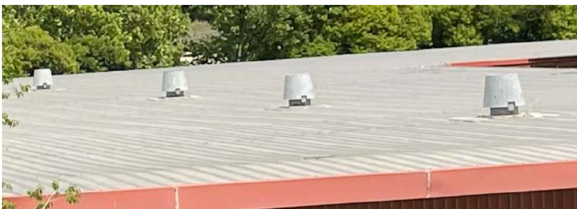
Figura 3. Salida de extractores de cubierta.
