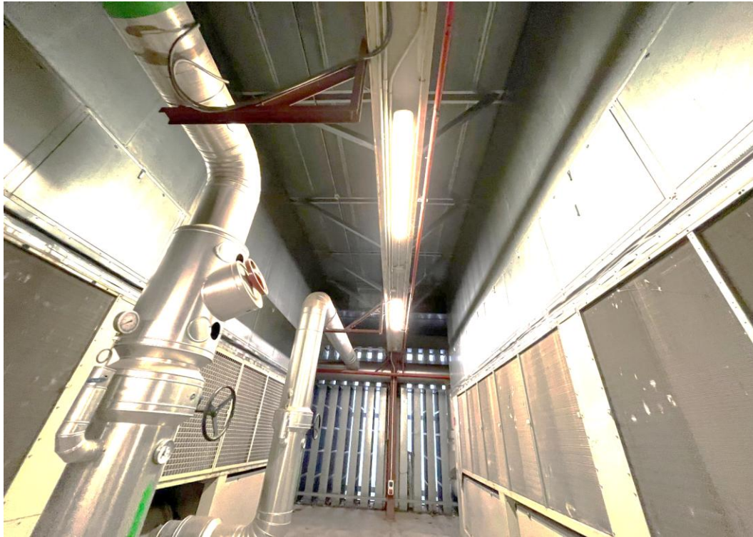
Sala máquinas Industrial I. Vista interior
